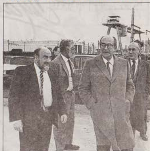
Claude Germon sur le chantier du pôle européen en compagnie de François Bourgeois. La filiale de l'empereur du bâtiment — France Construction — investit beaucoup à Massy.
